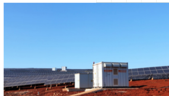
天合光能云南建水南庄300MW山地光伏电站 应用机型: SG 1000TS-M (下线)
