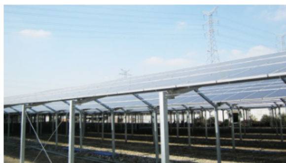
晶科能源海宁袁花镇红新村6MW农光互补项目 应用机型: SG 1000TS (下线)
