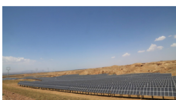
宁夏同心县隆基二期40MW光伏电站 应用机型: SG500MX SG 1000TS-M (下线)
